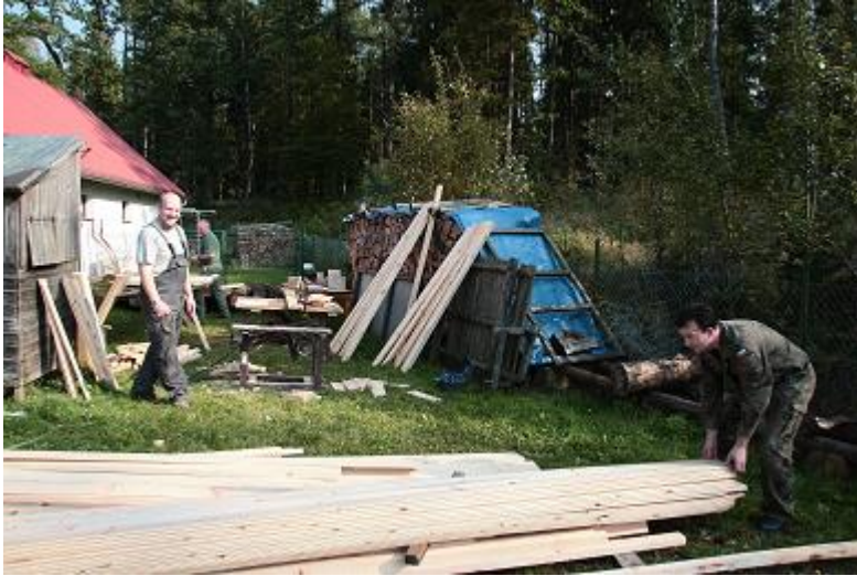
Fot. prace przy budowie ambony na terenie leśniczówki Barłomino. Przy pracy Mirosław Lech (łowczy koła) w najdalszym planie, Tadeusz Lech po lewej i Jan Arciszewski (układa deski)
